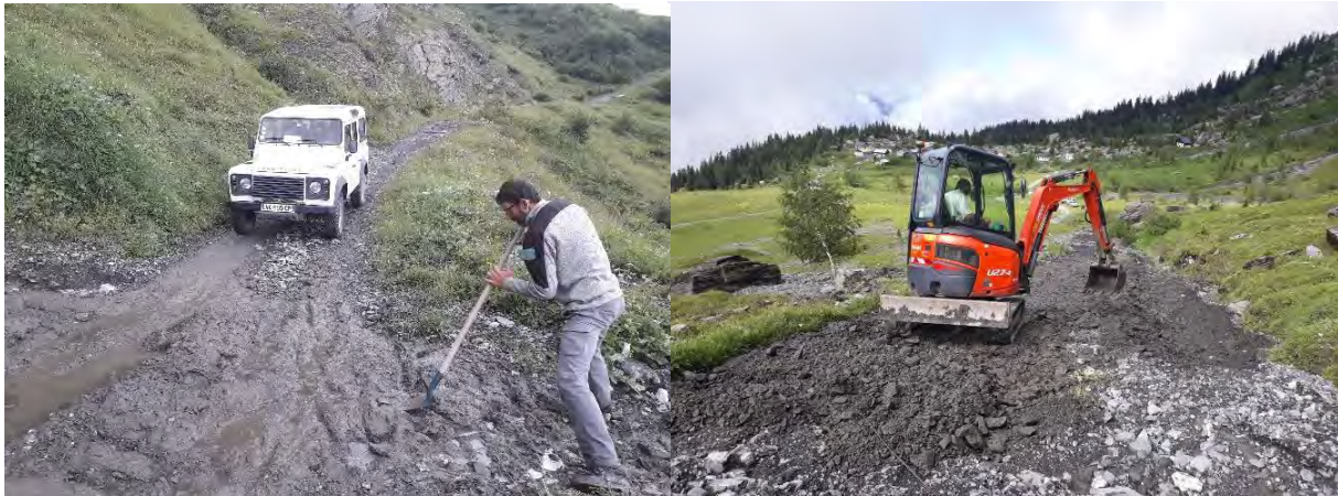
Dégâts causés par des coulées de boue sur la piste 4x4 – Été 2021
