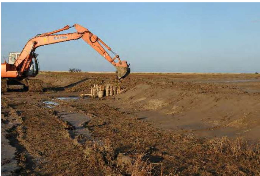
Photo 24 : Restauration d'une levée de terre (diguette) de la lagune - © RNN Marais d'Yves
